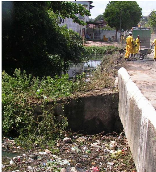
Figura 1: Acúmulo de lixo abaixo da ponte localizada no Banheiro do Soldado
