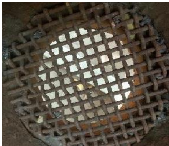
Figura 18 – Grelha de aço carbono.
