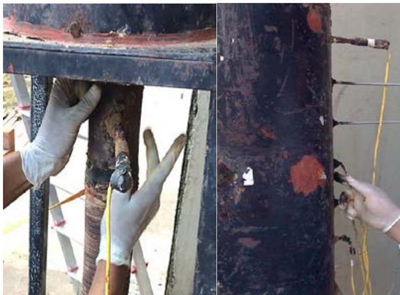
Figura 16 - Vedação dos termopares com argila umedecida e adesivo de silicone, respectivamente.
