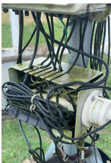
Central por onde passa toda a fiação dos sensores da EMA
