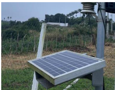
Painel solar que mantém o funcionamento independente da EMA
