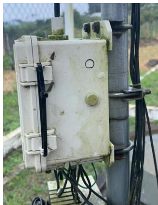
Quadro central onde estão o data logger, bateria e o receptor de dados dos sensores da EMA
