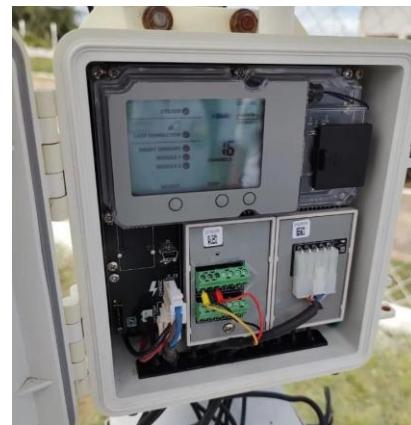
Data logger, módulo, bateria e central de coleta de dados da EMA
