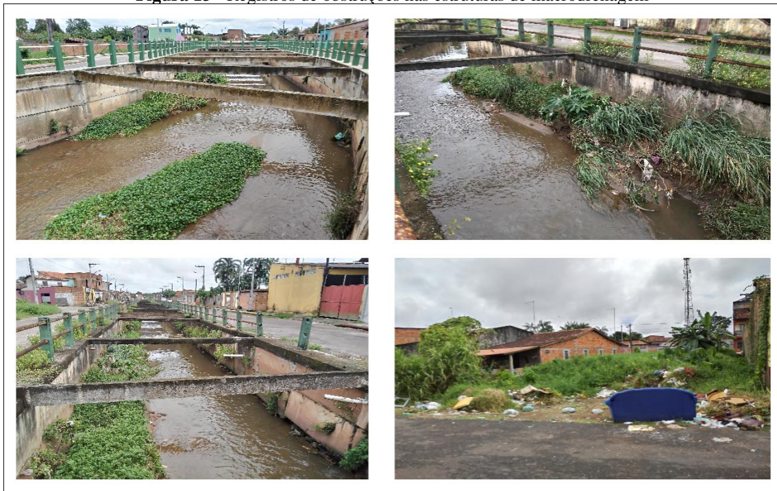
Figura 13 - Registros de obstruções nas estruturas de macrodrenagem
