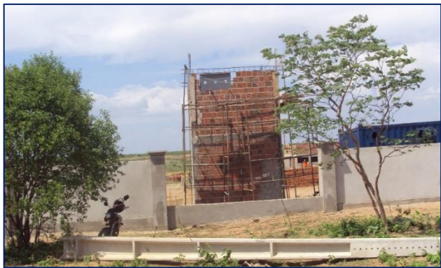
Imagem de Etapas da Construção do Cubículo de Medição e Proteção. Empresa CCW Engenharia Ltda. 28 de novembro de 2011
