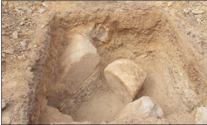
Imagem de Etapas da Construção dos Reservatórios Inferior e Superior, Construtora Proel Projeto de Engenharia e Construções Ltda. OS, 05 de dezembro de 2011
