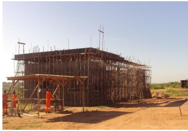
Imagem de Etapas da Construção do Prédio do Almoarifado e Patrimônio. Construtora Antártida Refrigeração, Serviços Técnicos e Construção Ltda. Início da obra 04 de julho de 2011
