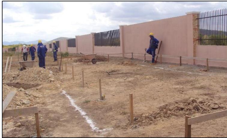
Imagem de Etapas da Construção dos Reservatórios Inferior e Superior, Construtora Proel Projeto de Engenharia e Construções Ltda. OS, 05 de dezembro de 2011
