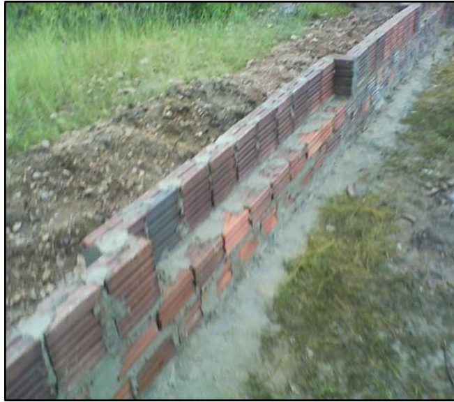
Imagem do início da construção dos muros de contorno do campus Angicos. Construtora Andrade Construções e Empreendimentos Ltda. Início da obra 29 de dezembro de 2008
