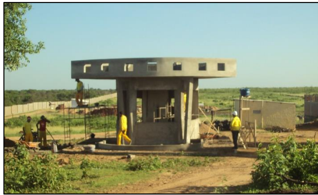
Imagem de Etapas da Construção do Muro e Guarita. Empresa Pilar Serviços Ltda. Início da obra 15 de agosto de 2011
