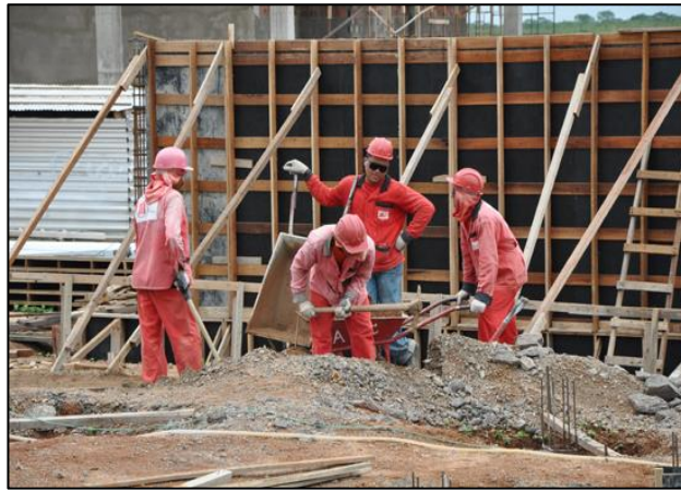
Imagem de Etapas da Construção do Reservatórios e Instalações de Redes Hidros Sanitárias. Empresa A & C Construções Ltda. 07 de novembro de 2011
