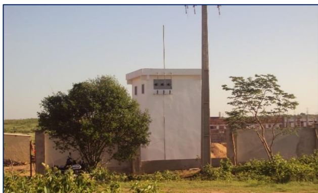
Imagem de Etapas da Construção do Cubículo de Medição e Proteção. Empresa CCW Engenharia Ltda. 28 de novembro de 2011
