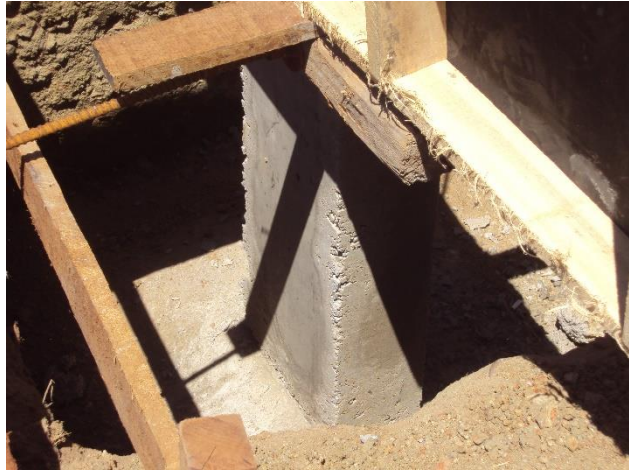
Imagem de Etapas da Construção do Bloco de Salas de Aulas. Empresa A & C Construções Ltda. Início da obra 04 de julho de 2011
