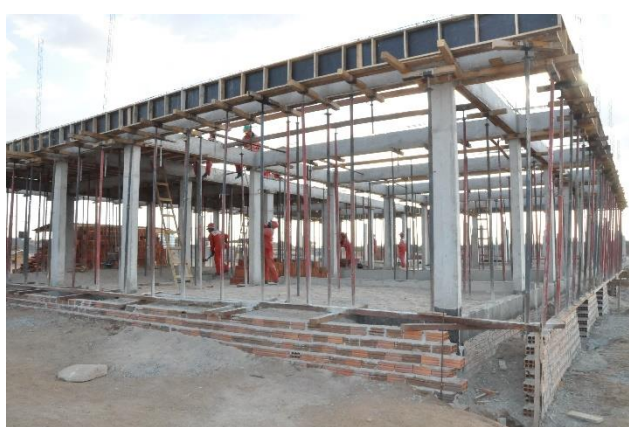
Imagem de Etapas da Construção do Bloco de Salas de Professores. Empresa Antártida Refrigeração, Serviços Técnicos e Construção Ltda. Início da obra 04 de julho de 2011
