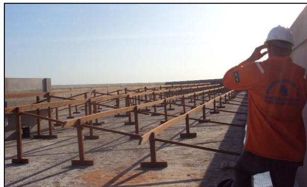
Imagem de Etapas da Construção do Bloco de Salas de Professores. Empresa Antártida Refrigeração, Serviços Técnicos e Construção Ltda. Início da obra 04 de julho de 2011
