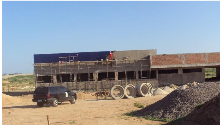
Imagem de Etapas da Construção do Bloco de Salas de Aulas. Empresa A & C Construções Ltda. Início da obra 04 de julho de 2011
