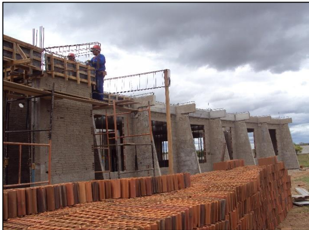
Imagem de Etapas da Construção do Prédio Administrativo, Construtora Proel Projeto de Engenharia e Construções Ltda. OS, 10 de janeiro de 2011
