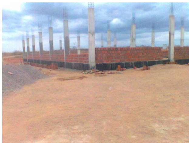
Imagem de Etapas da Construção do Prédio do Almoarifado e Patrimônio. Construtora Antártida Refrigeração, Serviços Técnicos e Construção Ltda. Início da obra 04 de julho de 2011
