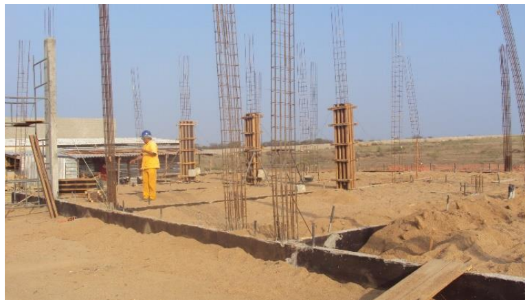
Imagem de Etapas da Construção do Bloco de Laboratórios. Empresa Pilar Serviços Ltda. Início da obra 04 de julho de 2011
