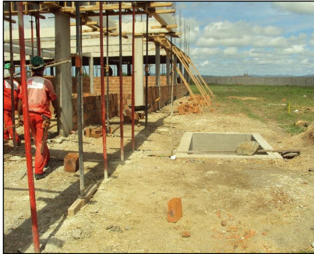
Imagem de Etapas do Início da Construção do Bloco de Sala de Aula. Construtora A & C Construtora Ltda. OS, 20 de dezembro de 2010
