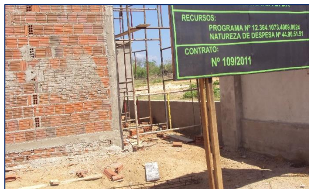
Imagem de Etapas da Construção do Cubículo de Medição e Proteção. Empresa CCW Engenharia Ltda. 28 de novembro de 2011
