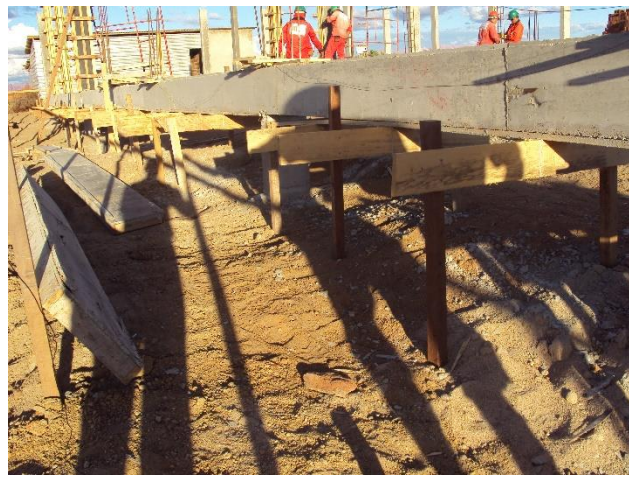
Imagem de Etapas da Construção do Bloco de Salas de Aulas. Empresa A & C Construções Ltda. Início da obra 04 de julho de 2011
