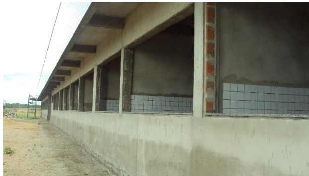
Imagem de Etapas da Construção do Bloco de Salas de Professores. Empresa Antártida Refrigeração, Serviços Técnicos e Construção Ltda. Início da obra 04 de julho de 2011
