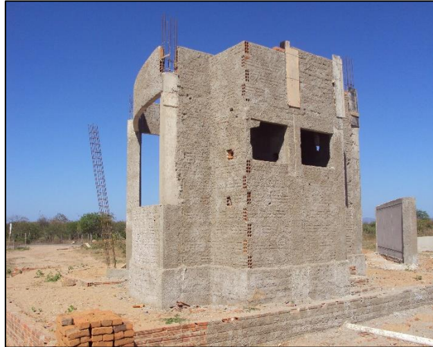
Imagem de Etapas da Construção: Muro de Contorno, Frontal e Guarita, Construtora Assú e Empreendimento Ltda. OS, 29 de novembro de 2010
