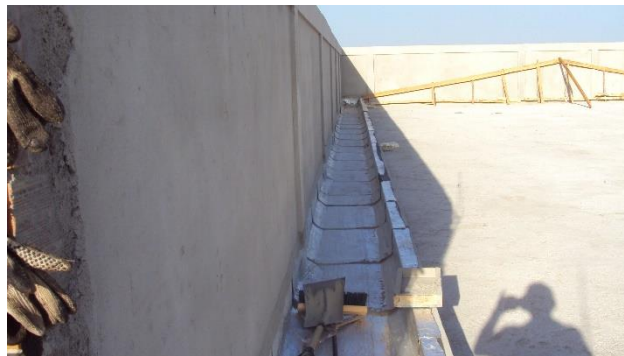
Imagem de Etapas da Construção do Bloco de Laboratórios. Empresa Pilar Serviços Ltda. Início da obra 04 de julho de 2011
