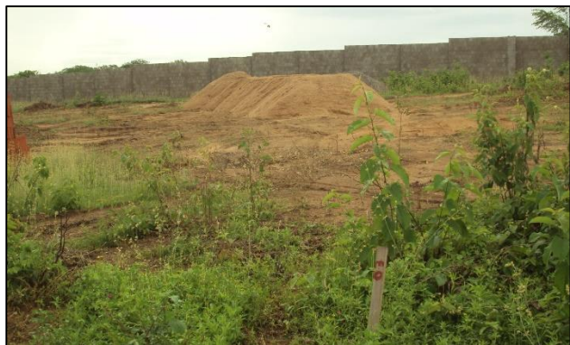
Imagem de Etapas da Construção do Muro e Guarita. Empresa Pilar Serviços Ltda. Início da obra 15 de agosto de 2011
