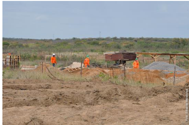
Imagem de Etapas da Construção do Bloco de Salas de Professores. Empresa Antártida Refrigeração, Serviços Técnicos e Construção Ltda. Início da obra 04 de julho de 2011
