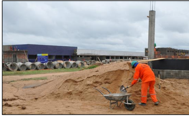
Imagem de Etapas da Construção do Prédio da Biblioteca. Empresa Antártida Refrigeração, Serviços Técnicos e Construção Ltda. Início da obra 08 de setembro 2011
