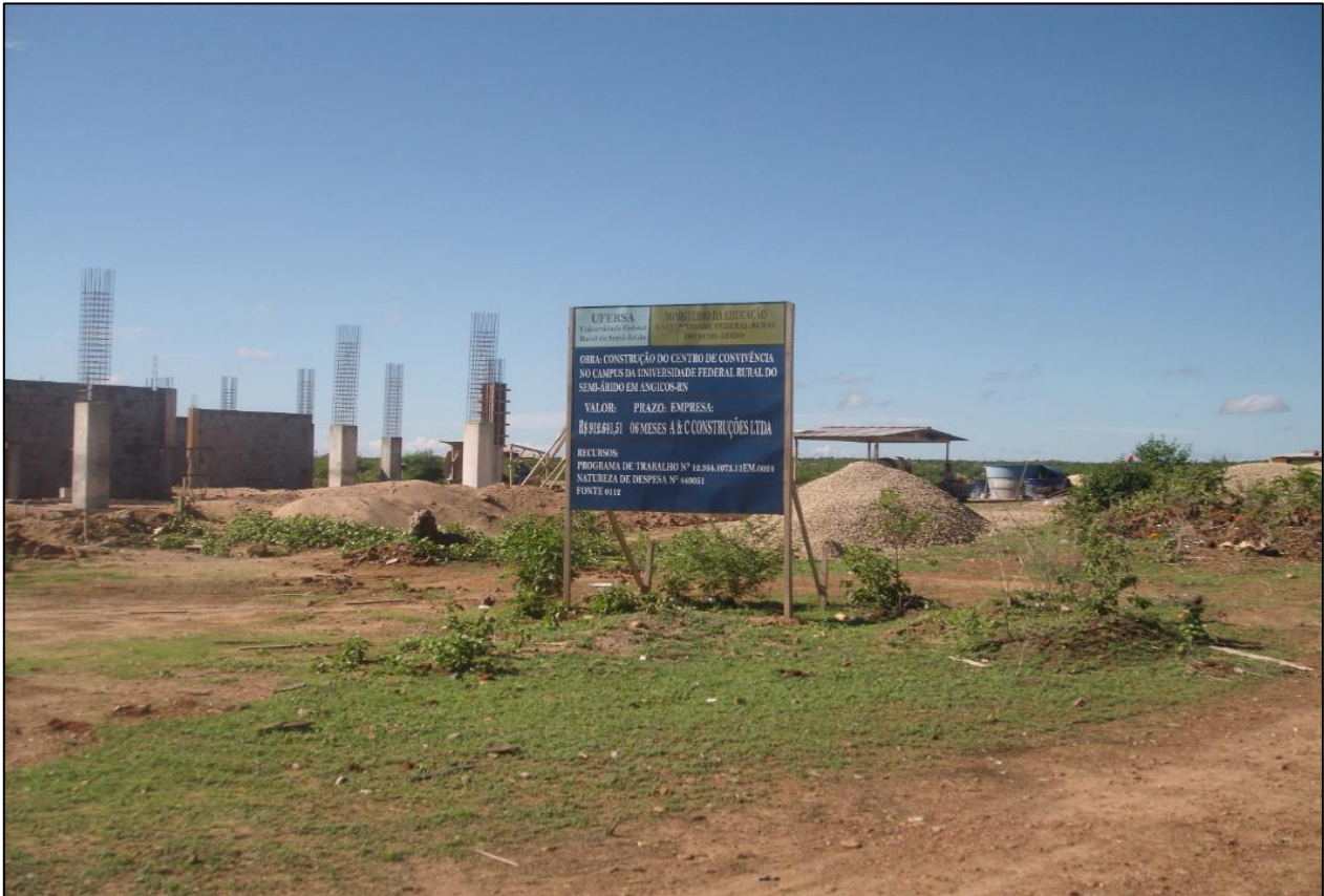
Imagem de etapas da construção do Prédio do Centro de Convivência e Auditório do Campus da Ufersa Angicos. Início da obra dezembro de 2008
