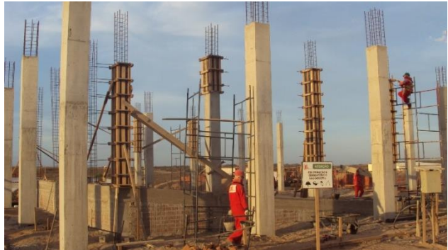
Imagem de Etapas da Construção do Centro de Convivência e Auditório. Empresa A & C Construções Ltda, Início da obra 22 de agosto de 2011
