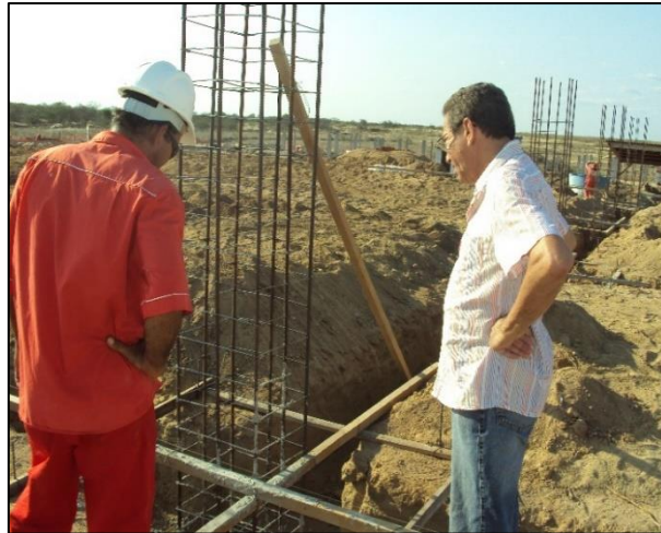
Imagem de Etapas da Construção do Bloco de Salas de Professores. Empresa Antártida Refrigeração, Serviços Técnicos e Construção Ltda. Início da obra 04 de julho de 2011
