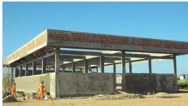
Imagem de Etapas da Construção do Prédio do Almoarifado e Patrimônio. Construtora Antártida Refrigeração, Serviços Técnicos e Construção Ltda. Início da obra 04 de julho de 2011
