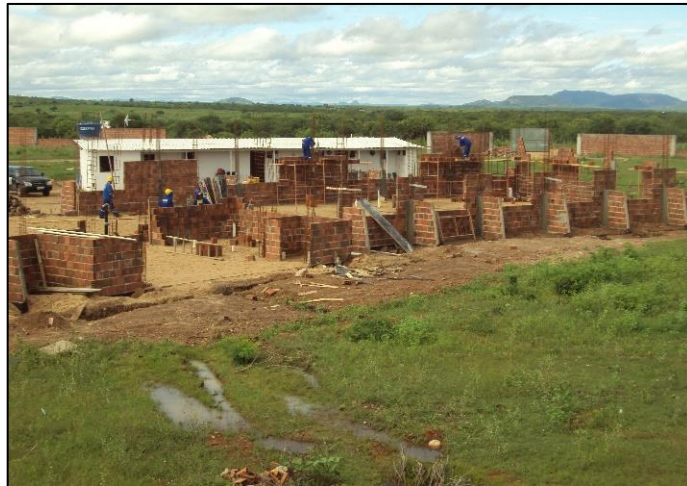
Imagem de Etapas da Construção do Prédio Administrativo, Construtora Proel Projeto de Engenharia e Construções Ltda. OS, 10 de janeiro de 2011
