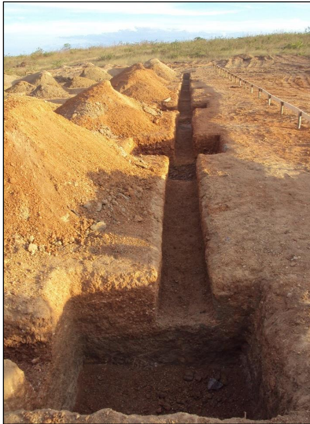
Imagem de Etapas da Construção do Prédio do Almojarifado e Patrimônio. Construtora Antártida Refrigeração, Serviços Técnicos e Construção Ltda. Início da obra 04 de julho de 2011
