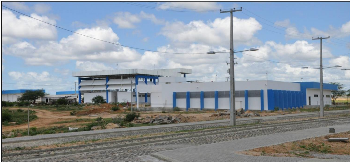
Imagem de etapas da construção do Prédio do Centro de Convivência e Auditório do Campus da Ufersa Angicos. Início da obra dezembro de 2008
