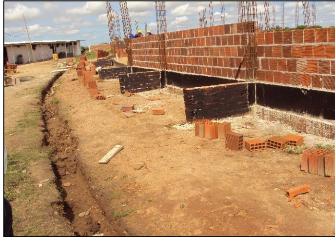
Imagem de Etapas da Construção do Prédio Administrativo, Construtora Proel Projeto de Engenharia e Construções Ltda. OS, 10 de janeiro de 2011
