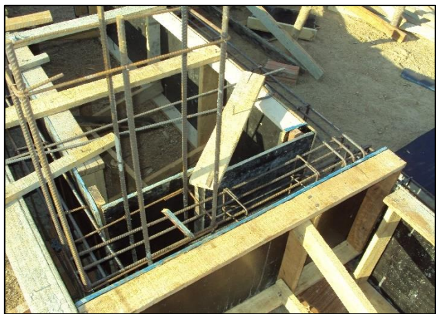
Imagem de Etapas da Construção do Centro de Convivência e Auditório. Empresa A & C Construções Ltda, Início da obra 22 de agosto de 2011
