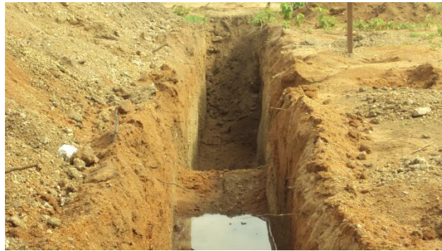
Imagem de Etapas da Construção do Prédio Administrativo. Construtora Pilar Serviços Ltda. 09 de janeiro de 2012
