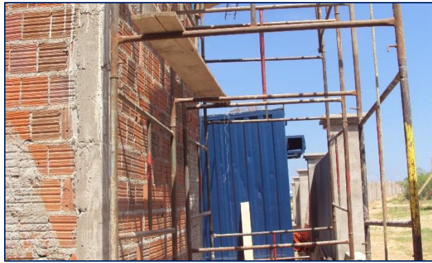
Imagem de Etapas da Construção do Cubículo de Medição e Proteção. Empresa CCW Engenharia Ltda. 28 de novembro de 2011
