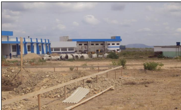
Imagem de Etapas da Construção dos Reservatórios Inferior e Superior, Construtora Proel Projeto de Engenharia e Construções Ltda. OS, 05 de dezembro de 2011
