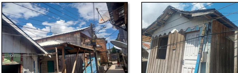
Figuras 11 e 12: Distribuição da fiação elétrica na Rua Otaviano de Melo
